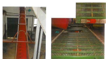
Parafusos sem fim e Tanque
