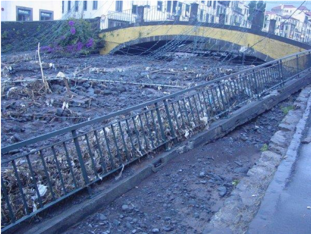
Figura 2 - Ocupação por detritos do trecho canalizado da Ribeira de Santa Luzia (Funchal).
