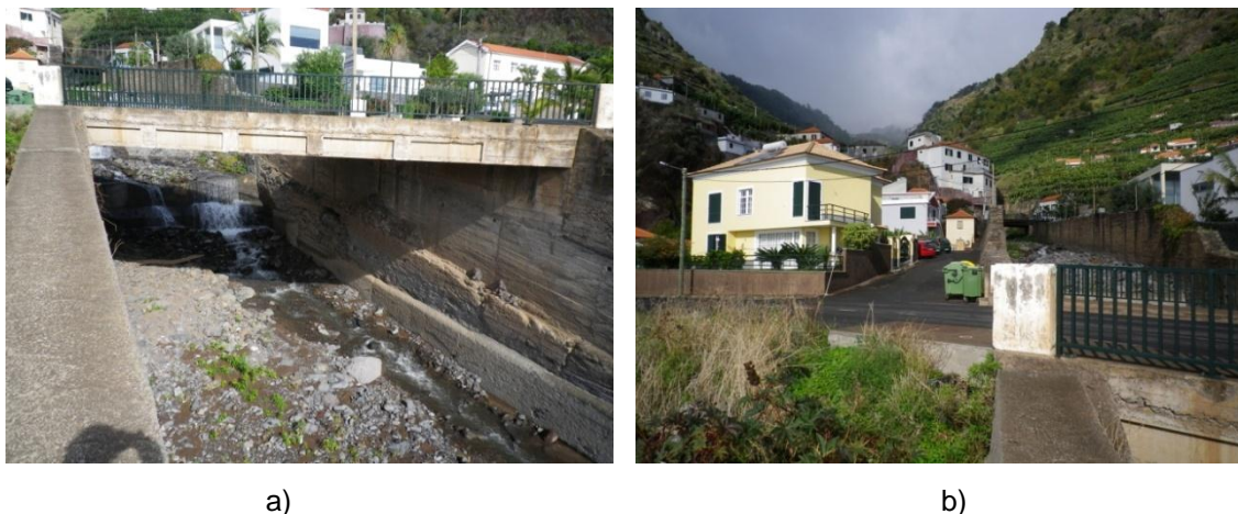
Figura 7.5 – Ponte RMM2: a) Vista de jusante. b) Encontro a reposicionar.
