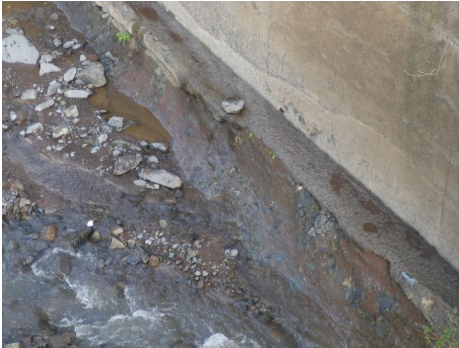
Fotografia 6.9 – Sobreescavação da fundação dos muros.
