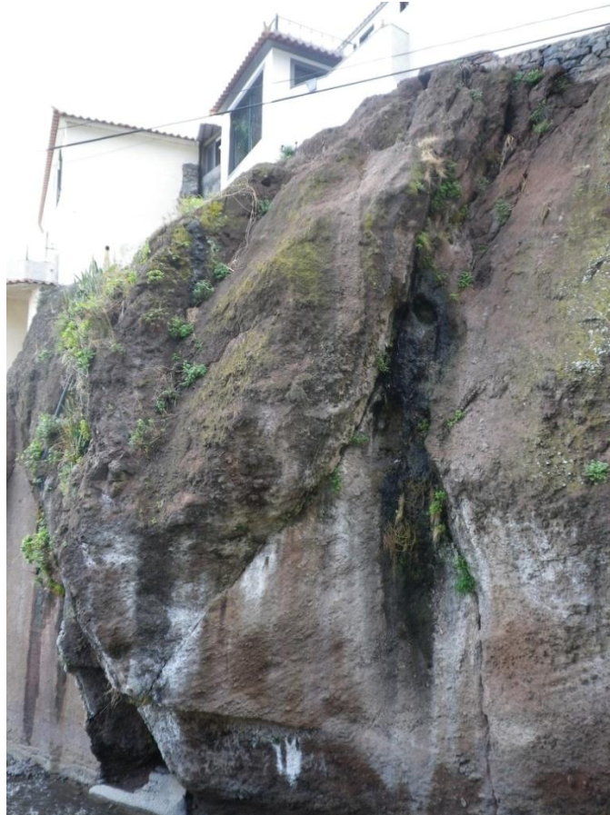
Fotografia 6.8 – Zona de potencial instabilização.
