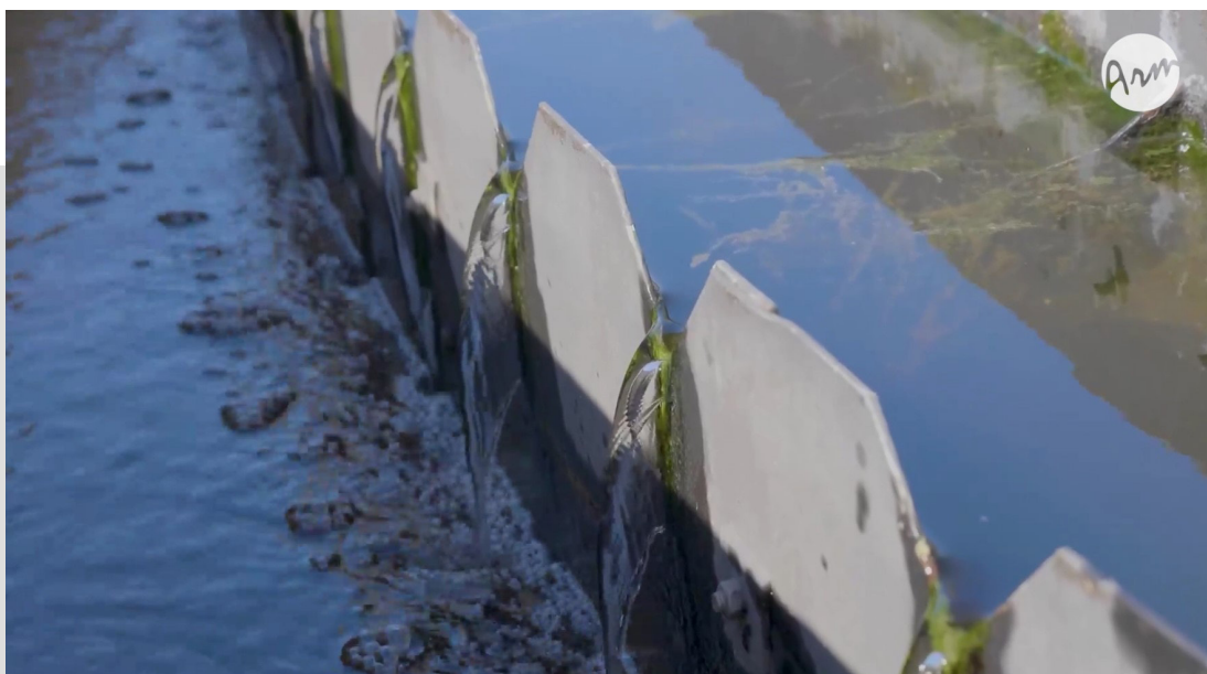
Tratamento Biológico da ETAR da Ponta, Porto Santo
