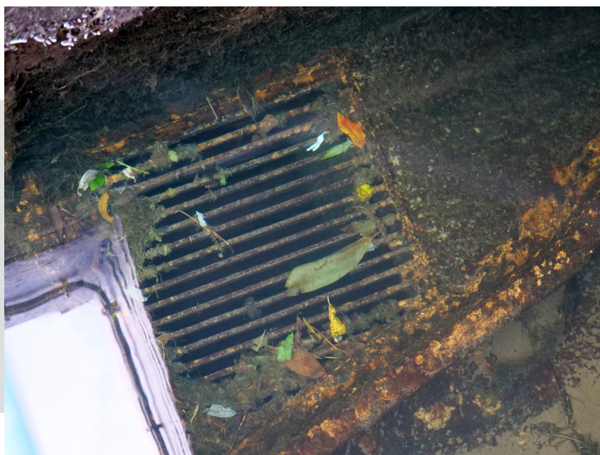
Captação de água na ETA do Covão
