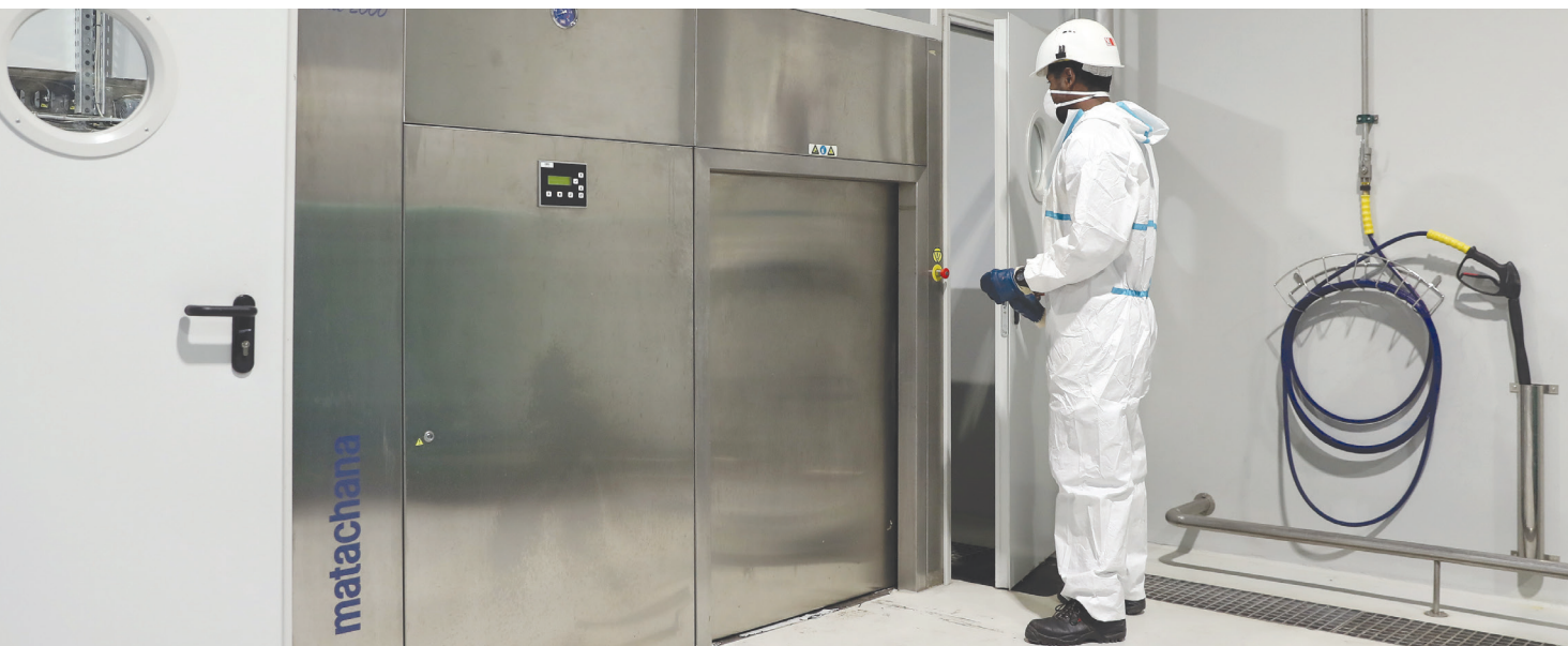
Autoclavagem, ETRS da Meia Serra
