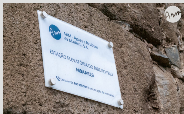
Visita à Estação Elevatória do Ribeiro Frio, em Santana
