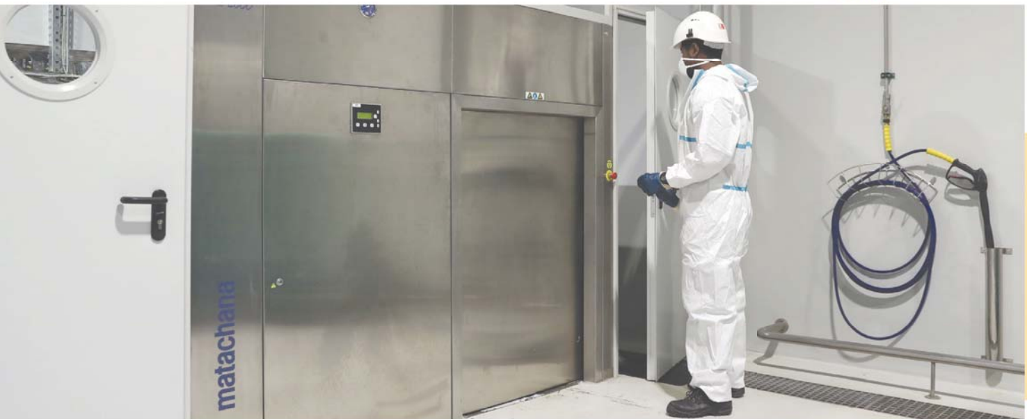
Autoclavagem, ETRS da Meia Serra
