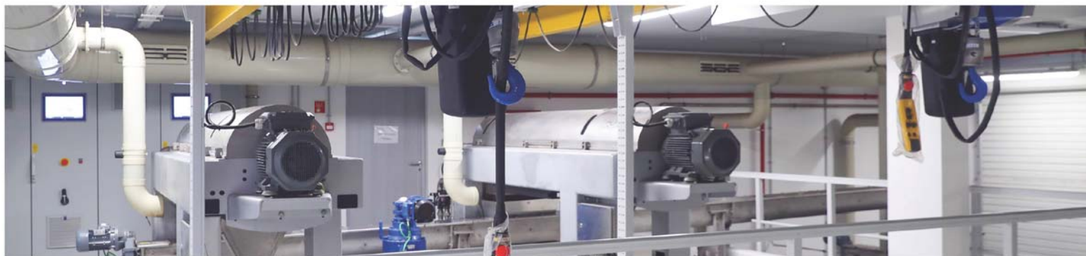
Infraestruturas associadas à drenagem de águas residuais - ETAR de Câmara de Lobos
