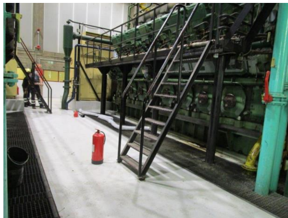
Foto 2 – Contenção do derrame junto ao G14
