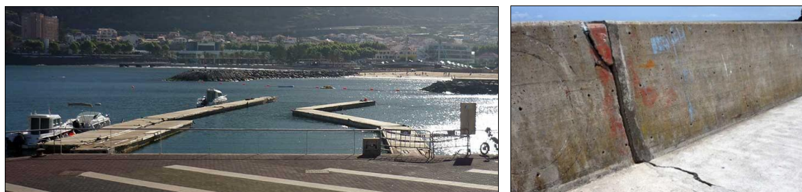
FIGURA 6.3 – PORTO DE MACHICO – FISSURAMENTO DO MURO CORTINA E CAIS EM DIVERSOS PONTOS E DESTRUIÇÃO DOS PASSADIÇOS FLUTUANTES E FINGERS
