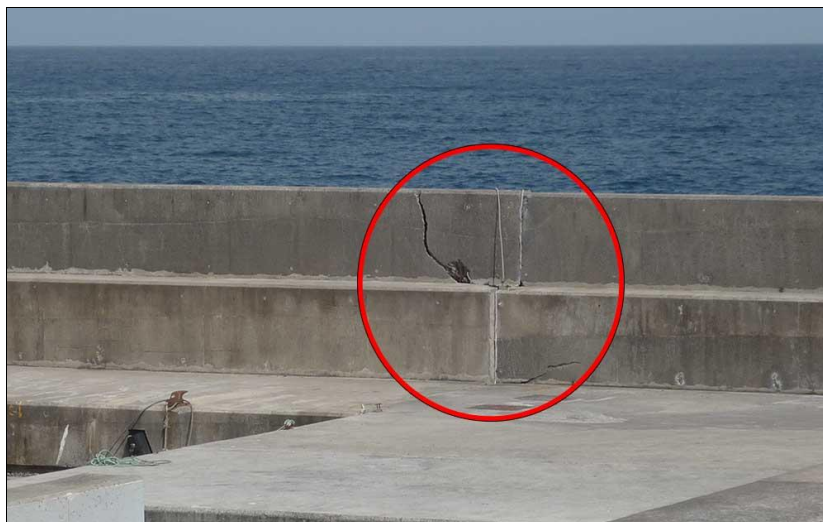
FIGURA 6.4 – PORTO DE RECREIO DE SANTA CRUZ – FISSURAMENTO DO MURO CORTINA E CAIS EM DIVERSOS PONTOS E DESTRUIÇÃO DOS PASSADIÇOS FLUTUANTES
