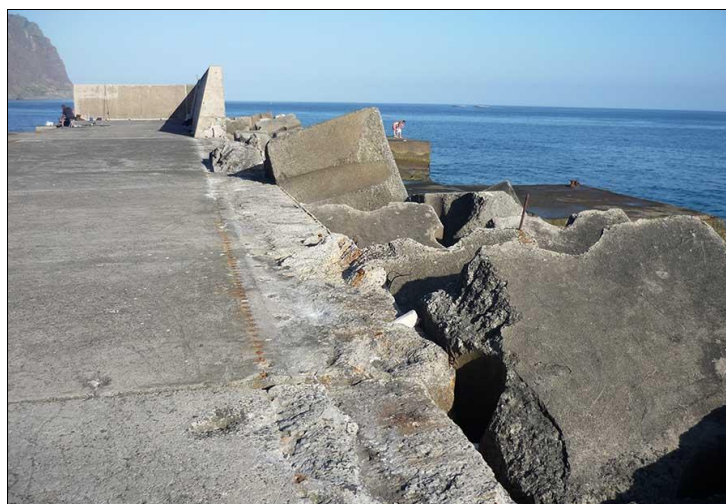
FIGURA 6.5 – PORTO DA RIBEIRA BRAVA – COLAPSO DO MURO CORTINA
