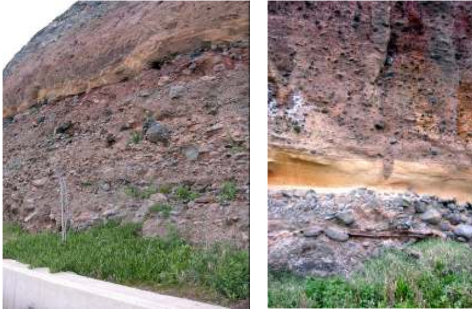
Fot.s 30 e 31 – Aspecto caótico dos materiais piroclásticos existentes no Complexo \beta_1 entre o Caniçal e a foz da Ribeira do Natal. À esquerda, observam-se escoadas lávicas intercaladas e, à direita, intercalações sedimentares (cor mais amarelada) distinguindo-se um pequeno canal aberto nos sedimentos.
